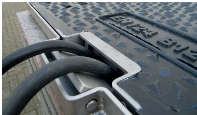
Die Leitungen der Verbraucher werden bei geschlossenem Deckel nach Außen geführt.
